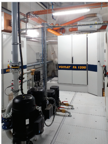
Oddělená strojovna, kde firma filtruje olej, použitý vzduch z haly, hluk a podobně.
